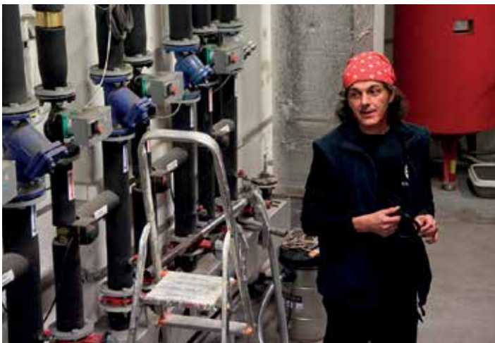
Martin Mach v rekonstruované školní kotelně. Teď se topí dřevní štěpkou, kterou si město vyrábí.
